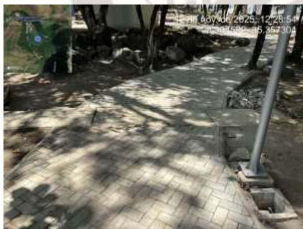
FOTO 09: CAIXAS DOS POSTES COM CABEAMENTO;
