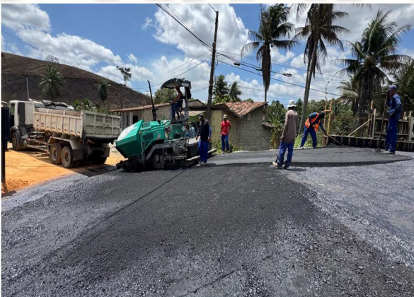
FOTO 5: ASFALTO NO 1º ENCONTRO;
